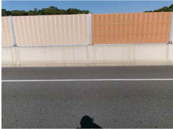
방호벽 S1 균열( Cw=0.3\text{mm} 이상)
