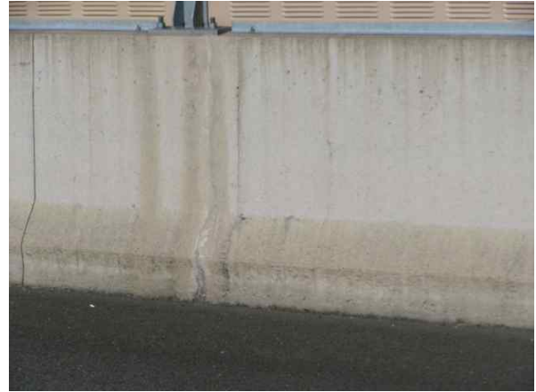
방호벽 S1 균열( Cw=0.3\text{mm} 이상)
